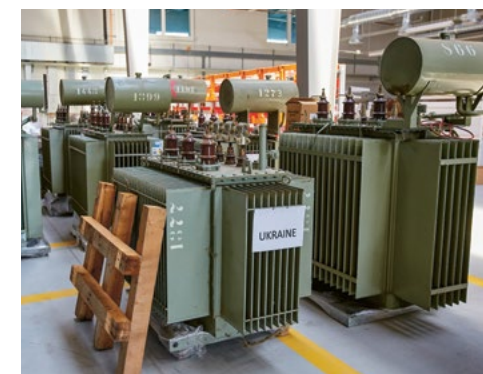
Von Partnerländern gespendet: Transformatoren für ukrainische Umspannwerke
