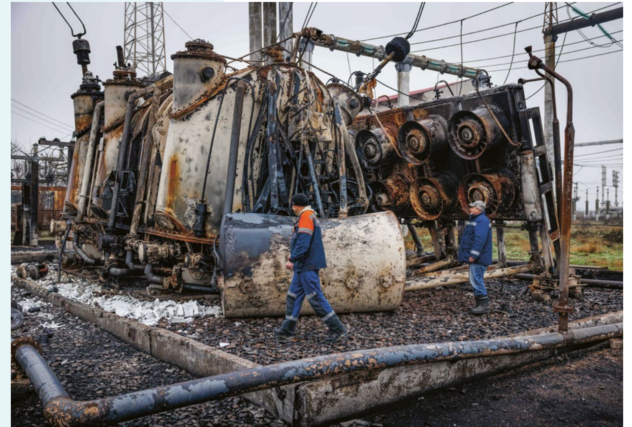
Ein von russischen Truppen zerstörter Transformator bei Cherson. Russlands Angriffe zielen auf die kritische Infrastruktur der Ukraine.
