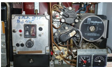
Abb. 26: Im Kessel eingebaute Pumpe – integriertes Pumpenmanagement ist wahrscheinlich
