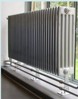
Stahlradiator (vor Glasfläche, ohne Strahlungs-schutz)
