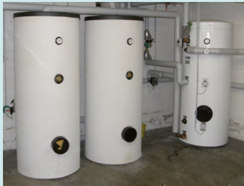
Großanlage (Puffer- und Trinkwarmwasserspeicher)
