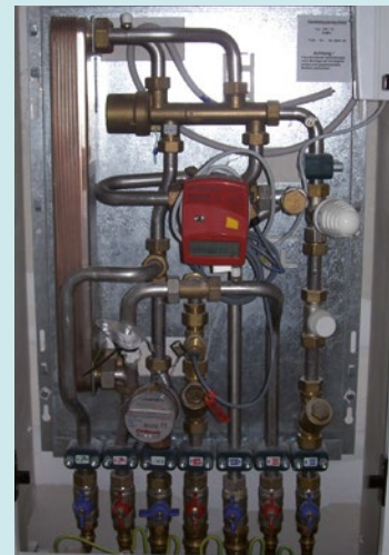
indirekte Übergabe als Übergabestation (Heizung und Warmwasser)
