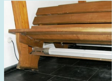
Elektrodirektheizung (als Bankheizung)
