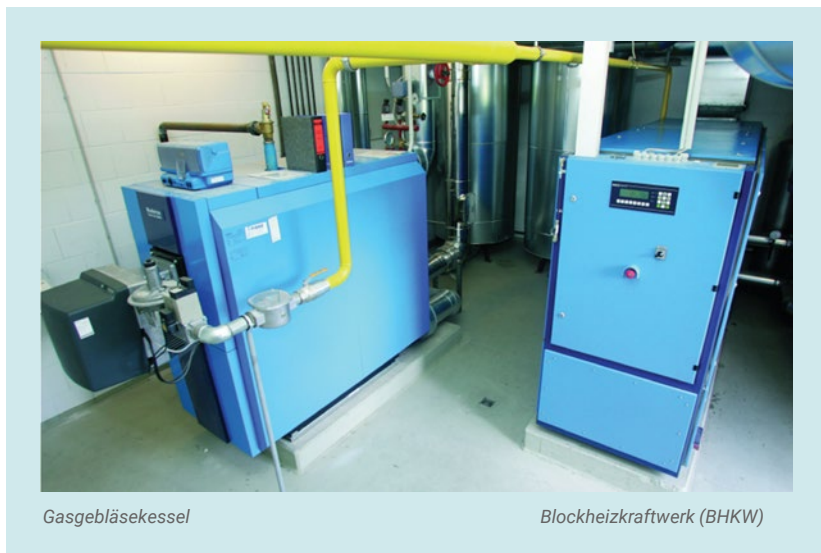
Abb. 48: Heizzentrale mit Blockheizkraftwerk und Kessel (Quelle: Buderus)
