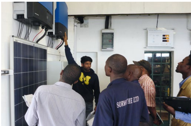
Eine praxisnahe Schulung für die Mitarbeiter von Sorwathe ermöglicht diesen, die Anlage eigenständig zu betreiben und zu warten. – Thanks to a practical training course, Sorwathe's staff are able to independently operate and maintain the installation.
