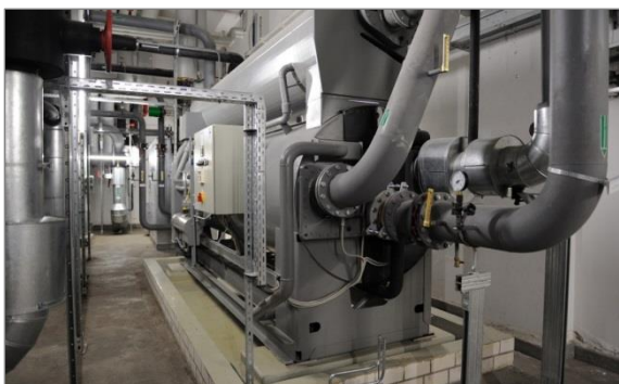
Die alte Kältemaschine.
