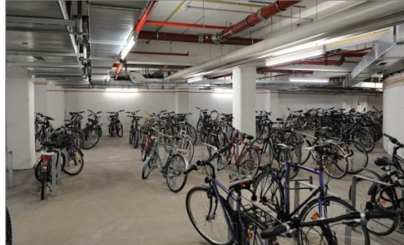
Innovative LED-Beleuchtung in einem Fahrradraum.
