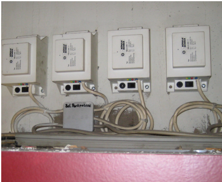
Elektronische Spannungsabsenkung (Kleinere Lichtstromkreise)
