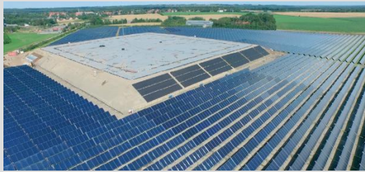
Abbildung 48: Erdbecken-Wärmespeicher mit Solarthermieanlage in Gram (Grafik: Gram Fjernvarmen).
