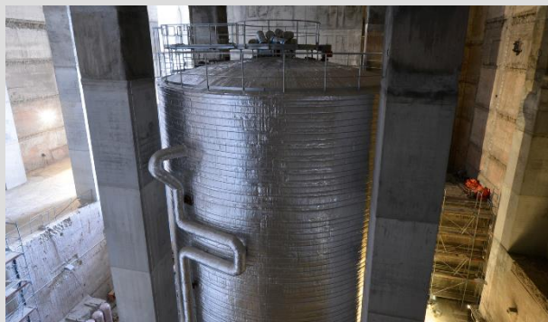
Abbildung 51: Großpufferspeicher im Energiebunker (Grafik: IBA Hamburg GmbH / Martin Kunze).
