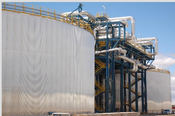
Abbildung 31: Flüssigsalzspeicher im solarthermischen Kraftwerk Andasol 3 (Bild: TSK Flagsol)
